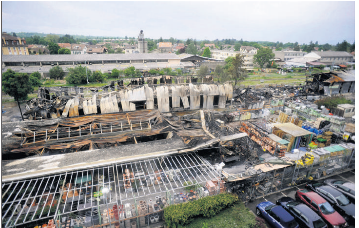
Lendemain d'hier. Les charpentes métalliques se sont affaissées et les tôles sont retombées comme des feuilles mortes vaincues par la chaleur. (LAURENT GUIRAUD)
